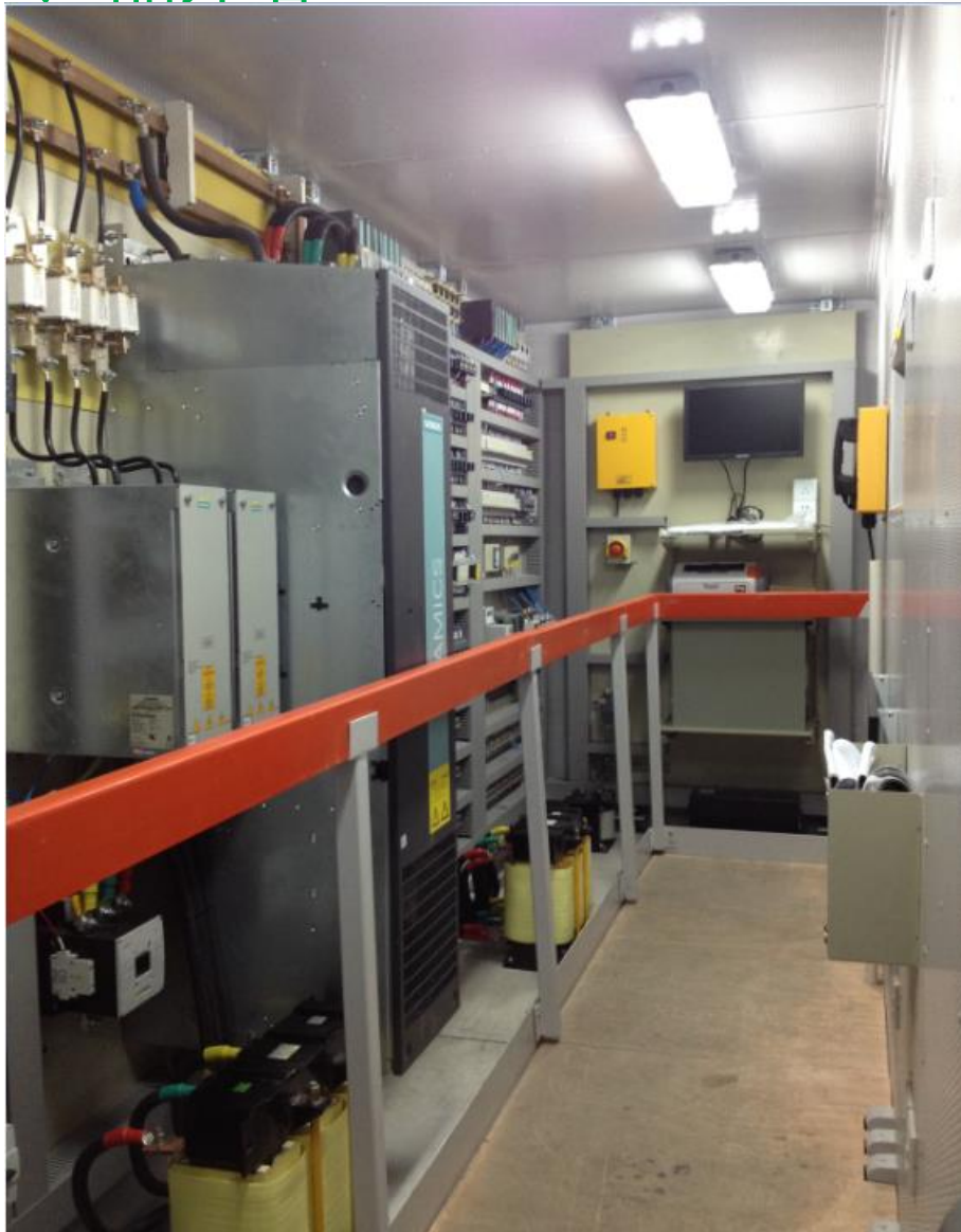
俄罗斯RTG龙门吊电气房
